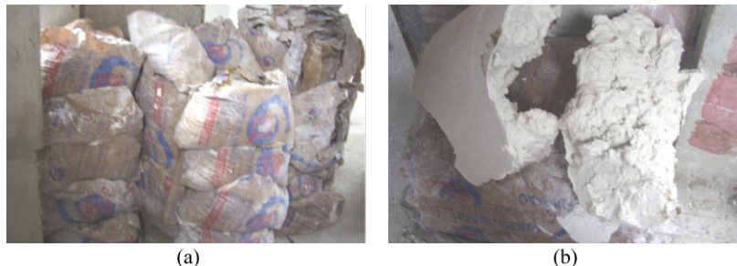
Figura 3 – Resíduo produzido por mão de obra não qualificada na execução do revestimento interno de parede: (a) resíduo total de um pavimento; (b) resíduo de uma masseira
